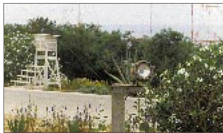
UV-Melder rund um die Mittelwellenantenne sorgten dafür, daß der Sender automatisch kurzzeitig „heruntergefahren“ wurde, wenn sich ein Lichtbogen bildete.
