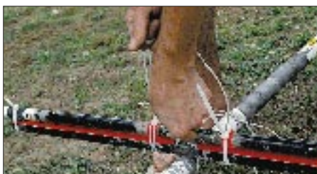
Die Einspeisung des Mosley-Beams: Die fehlenden Isolierstücke und U-Bügel wurden durch Isolierband und Kabelbinder ersetzt.
