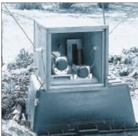
Bild 6: Die Abstimmereinheit wurde in einer wetterfesten Holzkiste untergebracht.
